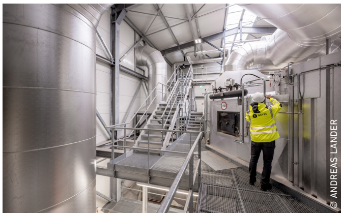
Kesselhaus mit Biomassekessel.
