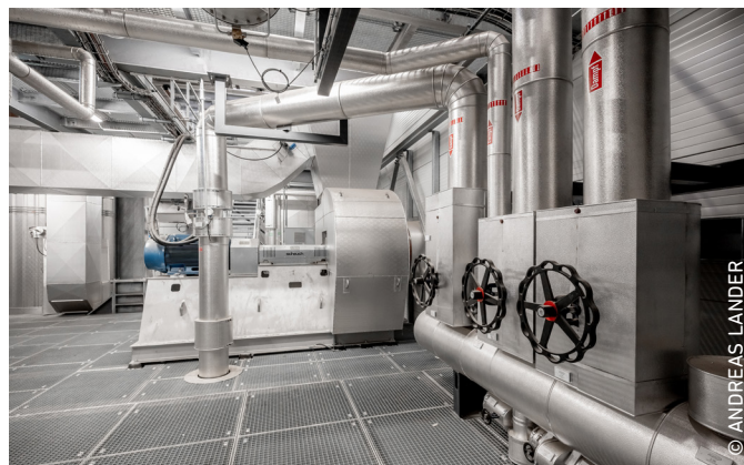
Prozessdampfverteilung und Verbrennungsluftgebläse.
